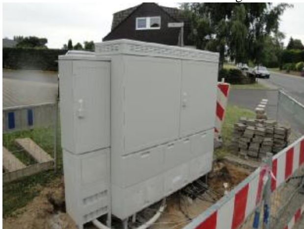
Abb. 9: Aufbau eines Outdoor-DSLAM als Überbau eines bestehenden KVZ
